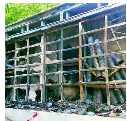
Das verkohlte Gebäude. ZVG
